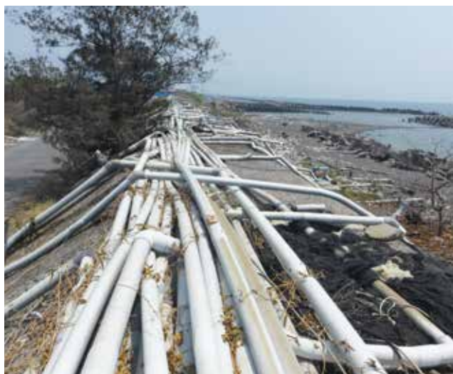
從海底抽水的水管橫跨過堤坊，在滿佈水管的堤防上景觀綿延數十里遠。
